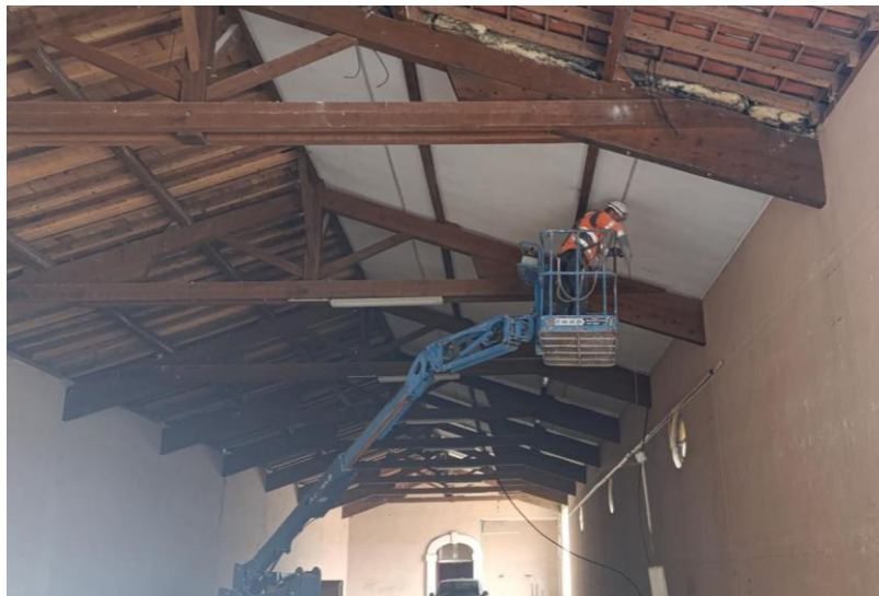
Figure 1 : Opération de curage à la nacelle : Electricité, doublage et isolation - Chai du château Haut-Brion
